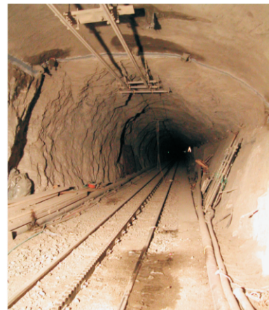
Trasse im Tunnel
